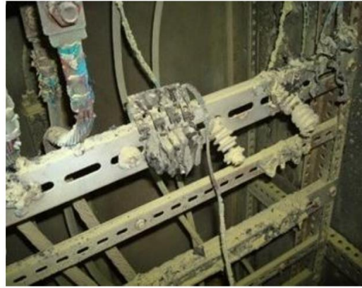
图 1-12 直流柜烧毁实物照片
