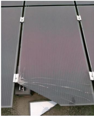
图 1-6 镇江光伏组件破裂
