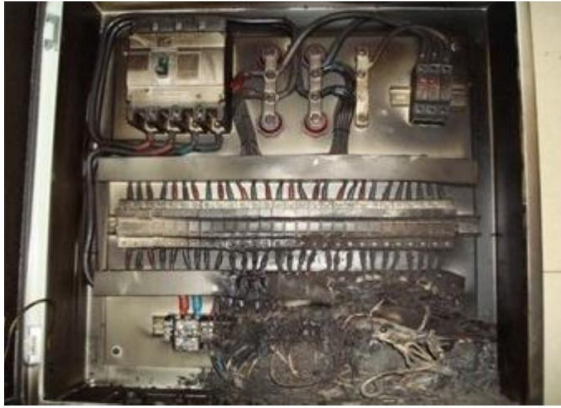
图 1-11 汇流箱烧毁实物照片
