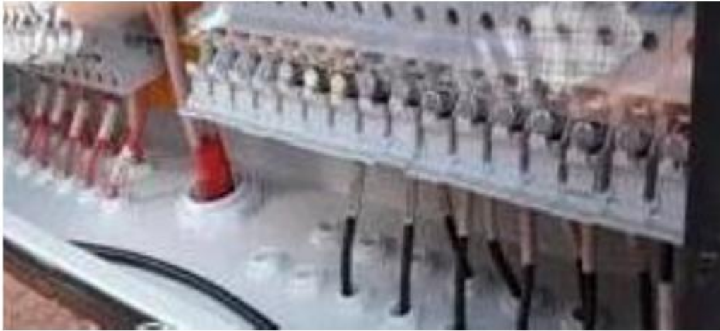
图 2-2 汇流箱未封防护泥
