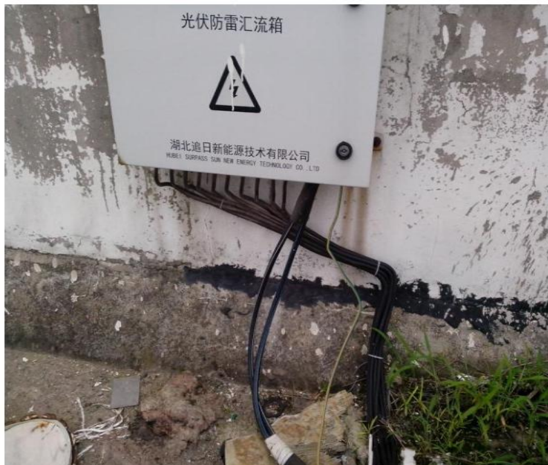
图 1-13 镇江项目中汇流箱未接地线
