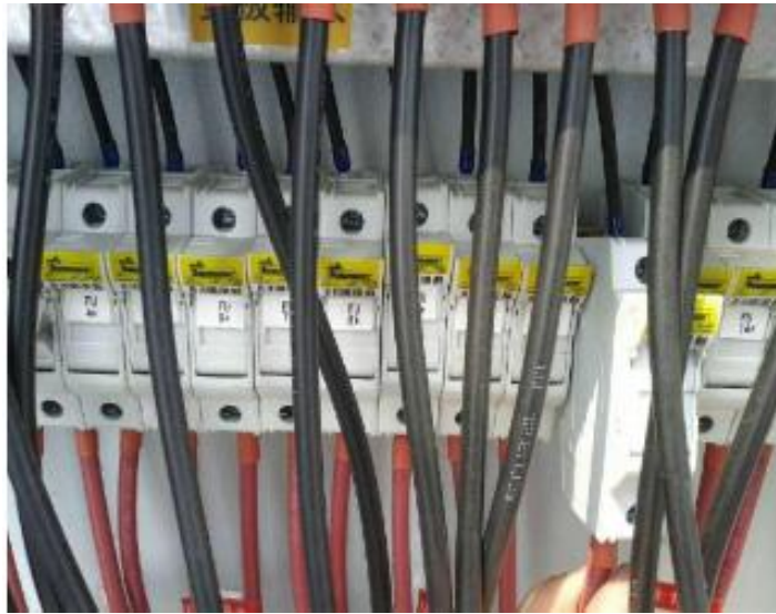
图 1-16 汇流箱走线混乱
