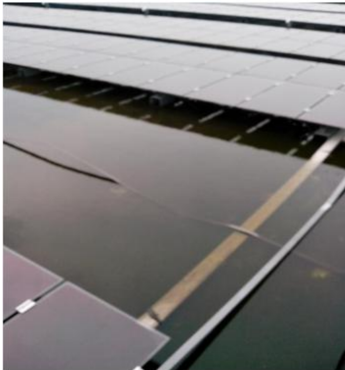
2-6 镇江项目屋顶积水无法排出
